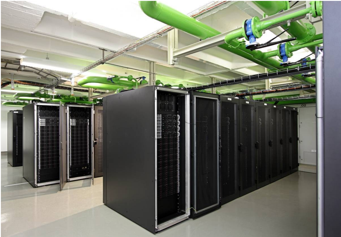
Figur 1: Hochleistungsrechner LOEWE-CSC untergebracht in 34 Wasser gekühlten Schränken
